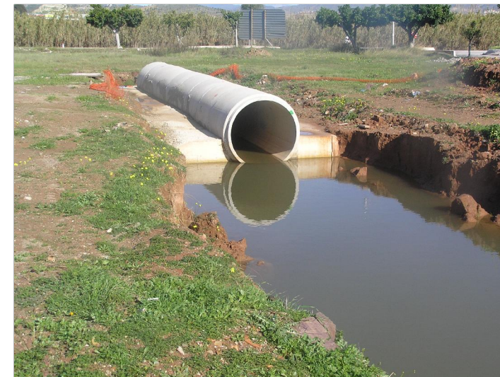
F1 Tubo aguas abajo
