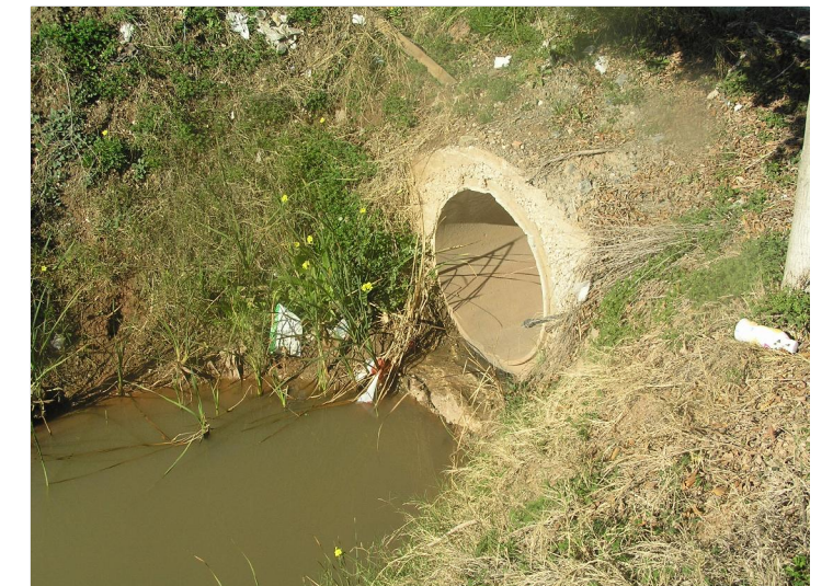
F2 Tubo aguas abajo
